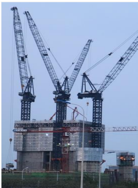
塔吊配置不经济
